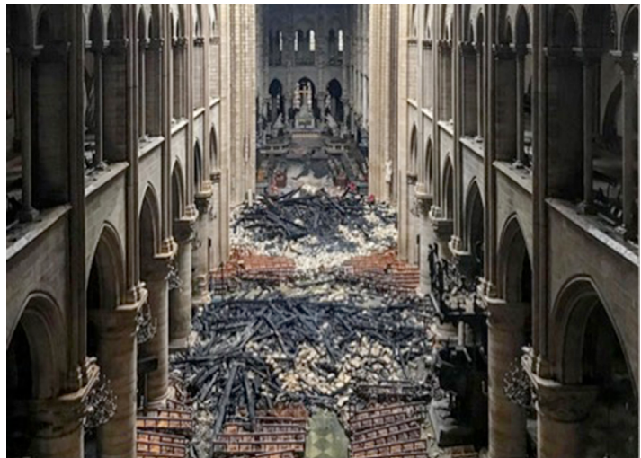
Figura 7. Estado de la nave central después del siniestro. Fuente: https://expansion.mx/mundo/2019/04/17/que-se-perdio-y-que-se-salvo-en-notre-dame
