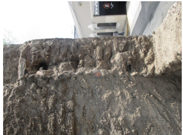
Figuras 16 y 17. Vista de las alturas de los muros de adobe exteriores, de 4.72 m; con un ancho de 0.60 m. Tamaño del adobe de 0.53 largo, x 0.28 de ancho x 0.10 m espesor. Fuente: Jiménez (2006-2007).
