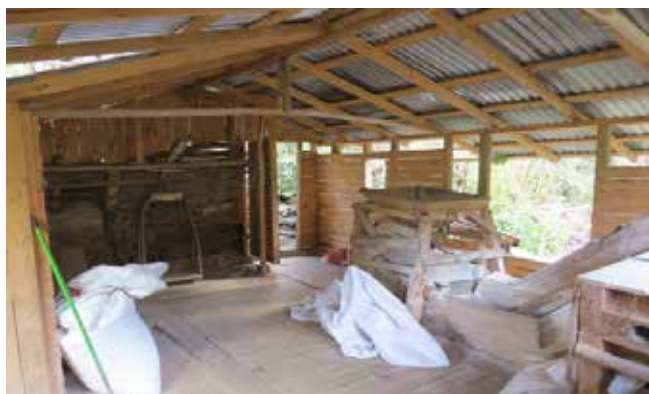
Figura 10. Detalle de un recinto, reparado artesanalmente por sus dueños después del terremoto de 2010. Molino de Pañul, Pichilemu. Registro fotográfico: Bravo, J., 2015, Santiago de Chile.
