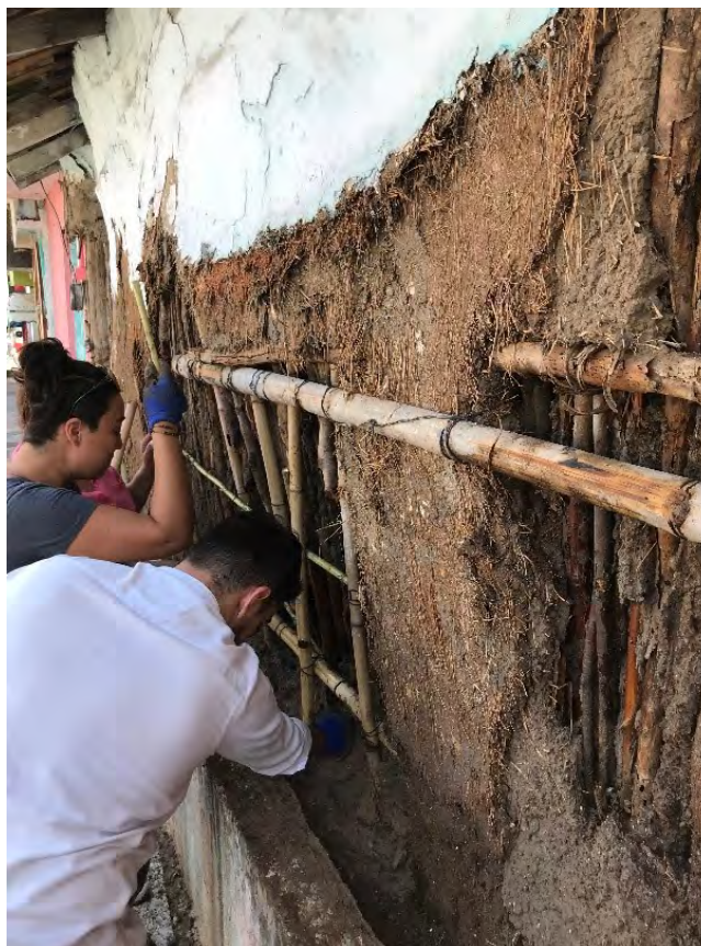
Figura 11. Colocación y atado de un emparrillado hecho de bambú. Tuxtla Gutiérrez, Chiapas. Foto: L. Guerrero.
