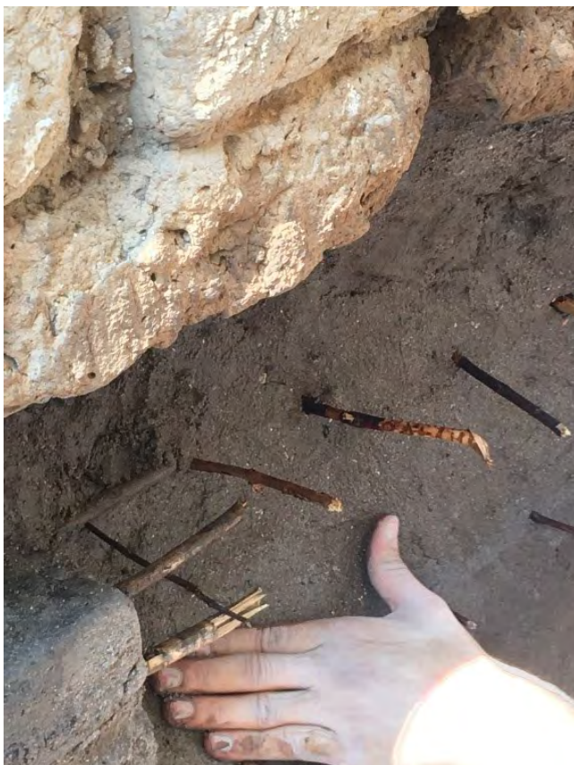
Figura 12. Aplicación de las esferas sobre las varas ancladas al contorno de un hueco derivado de la erosión de adobes, Lagos de Moreno, Jalisco. Foto: L. Guerrero.
