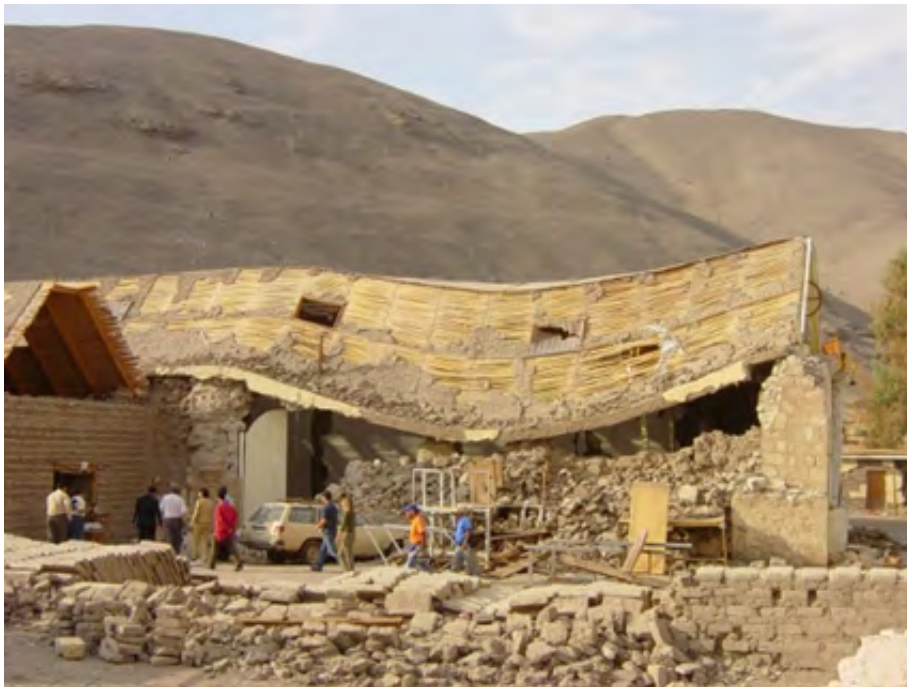
Figura 3. Daños provocados por la dala de concreto colocada sobre los muros de adobe del templo de San Lorenzo de Tarapacá, Chile, tras un terremoto en 2005. Foto: L. Guerrero.
