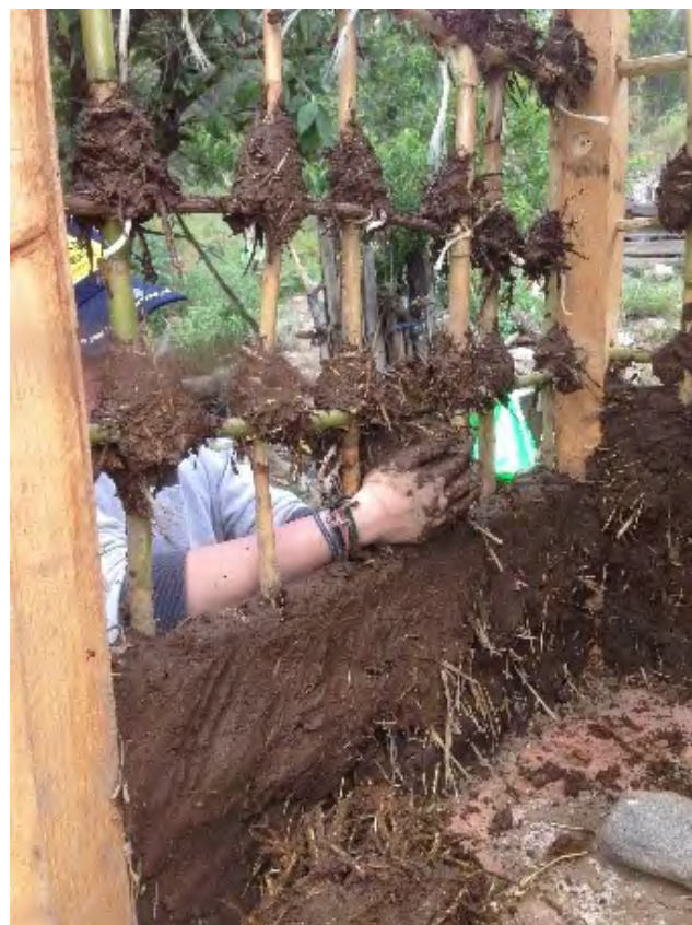
Figura 8. Estructura con entramado reticular para un sanitario seco realizado durante un taller infantil en Zautla, Puebla. Foto: L. Guerrero.
