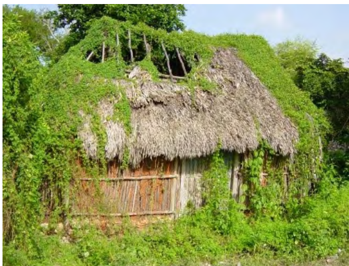
Figura 6. Ruinas de una casa vernácula de bajareque cerca de Mérida, Yucatán. Foto: L. Guerrero.
