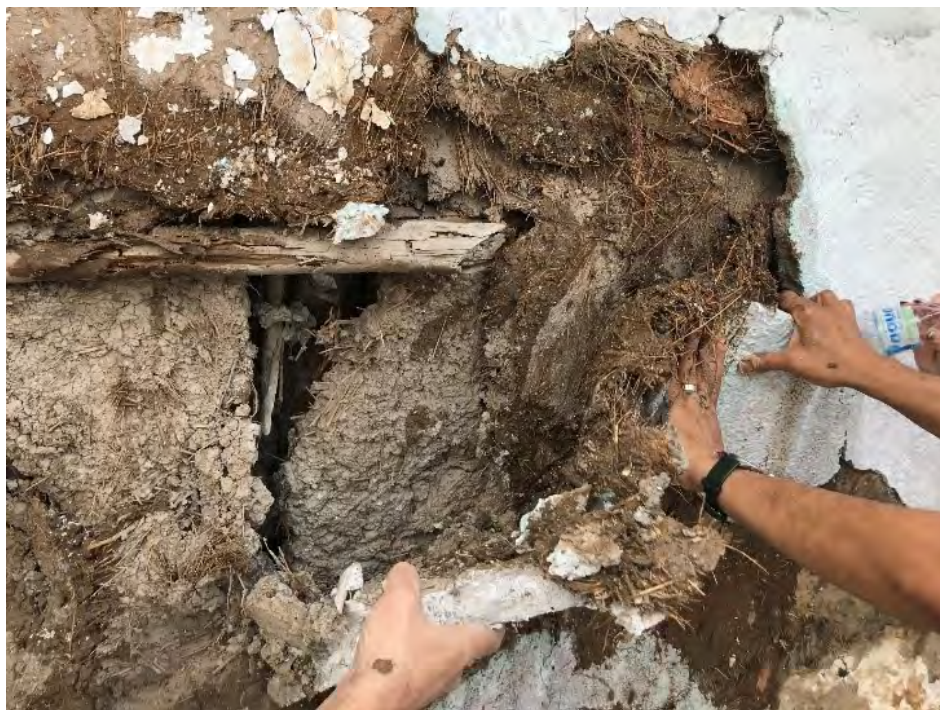
Figura 4. La gruesa capa de cemento con la que se recubrió esta casa tradicional de Tuxtla Gutiérrez, Chiapas, en los años setenta, provocó la acumulación de agua al interior del muro y la degradación de su entramado. Foto: L. Guerrero.
