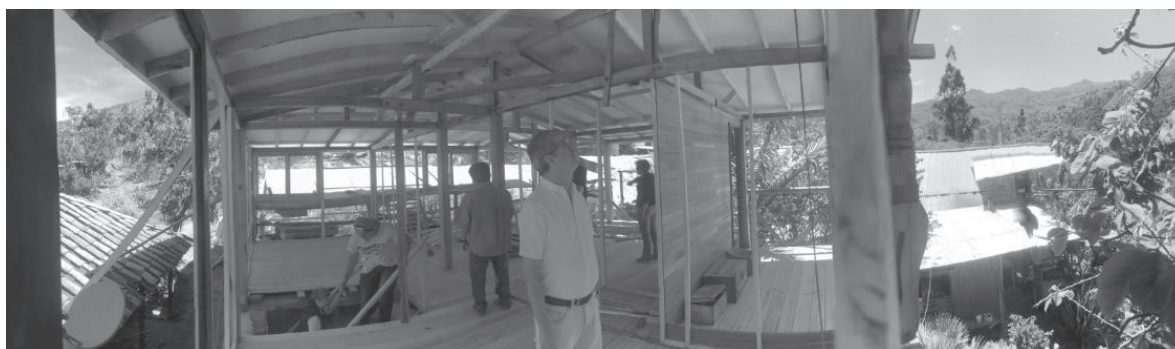
Figura 11. Proceso de construcción del segundo nivel, vivienda Rodríguez Vargas. Fuente: fotografía tomada por la autora en el año 2015.
