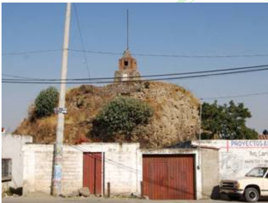
Fig. 5. El núcleo de la pirámide de Coyotzingo, Puebla, absorbido por la invasión urbana y convertido lamentablemente en los años cincuenta en la base de un monumento a la bandera, posee con un sorprendente estado de conservación adobes que miden 60cm x 40cm x 10cm. (Foto L. Guerrero)
