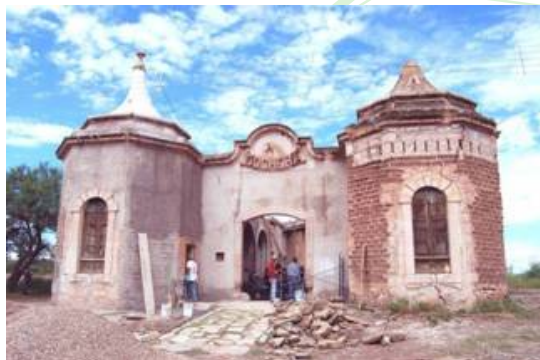
Fig. 7. Proceso de restauración de la monumental cochera de la Quinta Carolina, en Chihuahua construida totalmente en adobe por la familia Terrazas a finales del siglo XIX. (Foto L. Guerrero)
