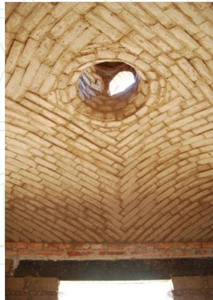
Fig. 9. Vista interior de una de las bóvedas de adobe del edificio realizado por Alejandra Caballero y Ramón Aguirre en el Proyecto San Isidro, Tlaxco, Tlaxcala. (Foto L. Guerrero)
