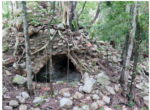
Figura 2. Edificio abovedado sin excavar en el conjunto conocido como "El Cuartel" de Santa Rosa Xtampak (Campeche). Laura Gilabert, 2017.
