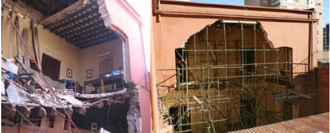
Figura 6. Derrumbe ocurrido en el Archivo provincial y posterior apuntalamiento interior. Fuente: Archivo de CECОВI.
