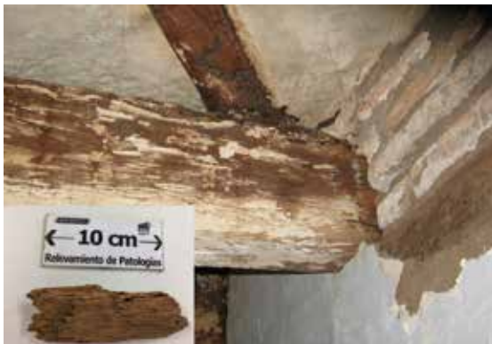
Figura 7. Humedad relevada en las tiranterías de madera; y un trozo de las mismas deteriorado. Fuente: Archivo de CECОВI.
