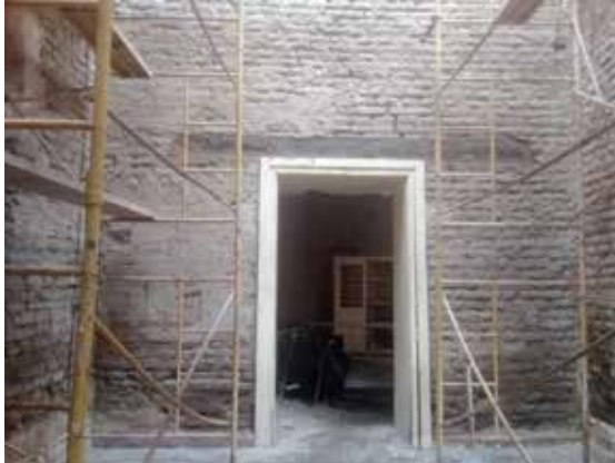
Figura 5. El adobe representa la mayor parte de la materialidad en obra. Fuente: Archivo de COEMYC S.A.
